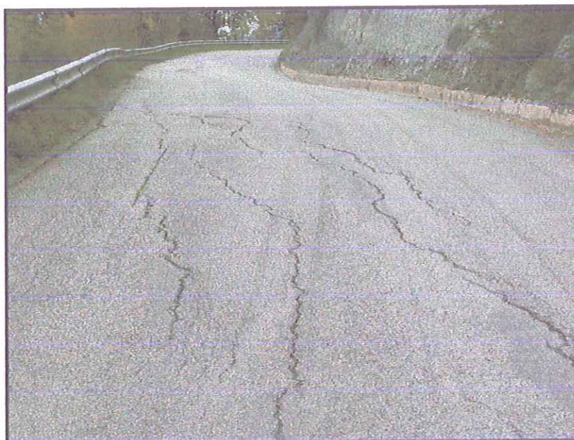
Fig. 10 - Lesioni della sede stradale in corrispondenza del versante est del centro storico
