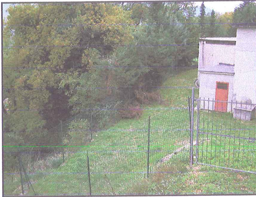
Fig. 11 - Manufatto dell'acquedotto, in prossimità di una scarpata in dissesto, con evidente tendenza retrogressiva
