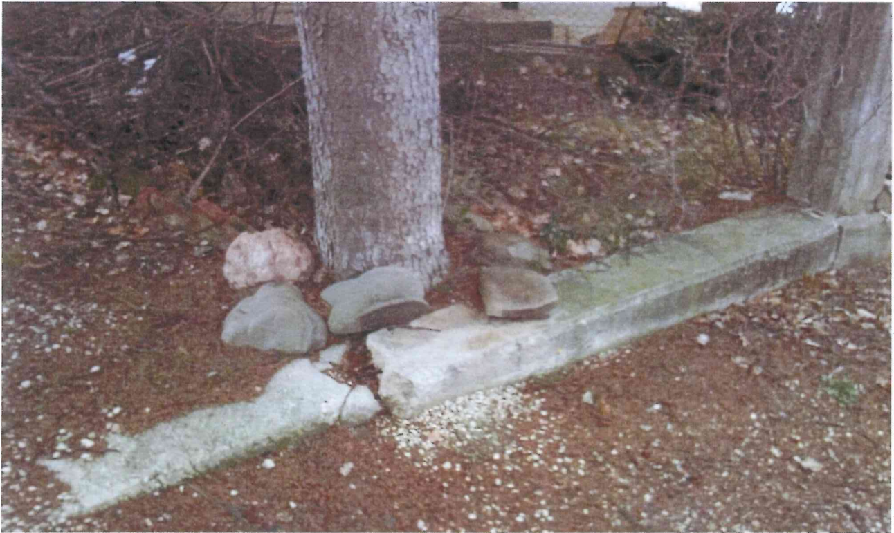
ABETE BIANCO N. 3 danni al muretto di contenimento
